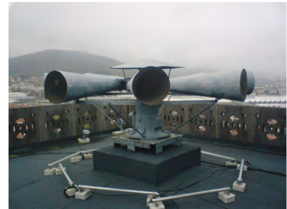
▲ Figure 14 : Sirène du Réseau National d'Alerte (RNA) - Source DDT 63
