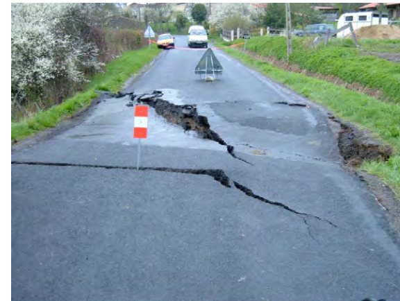
▲ Figure 31 : Glissement de terrain sur la commune de Montmorin (source: BRGM)
